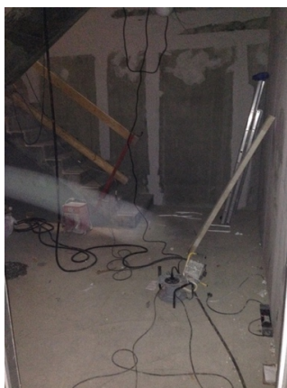
Rot og dårlig belysning på byggeplassen utgjør en sikkerhetsrisiko.
