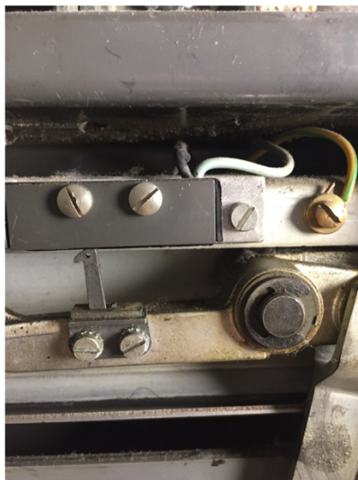
Noen har overkoblet en dørkontakt.
