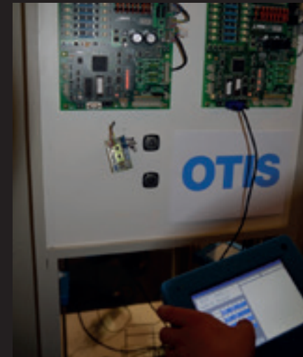
For 2000 Euro kan man kjøpe dette diagnoseverktøyet fra Modusystem som kan brukes på både Kone, Schindler, Thyssen, Otis og Orona sine styringer.
