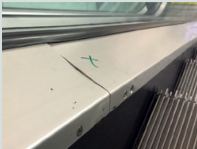
Deksel på balustradesokkel var løst og noe ute av posisjon. Ung jentes sko hektet og rev opp dekselet. Skader på fot.
