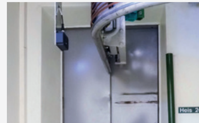
Heiser til automatisk transportsystem
