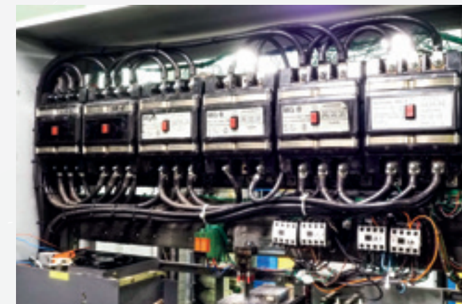
Kontaktorer Schindler heisstyring
