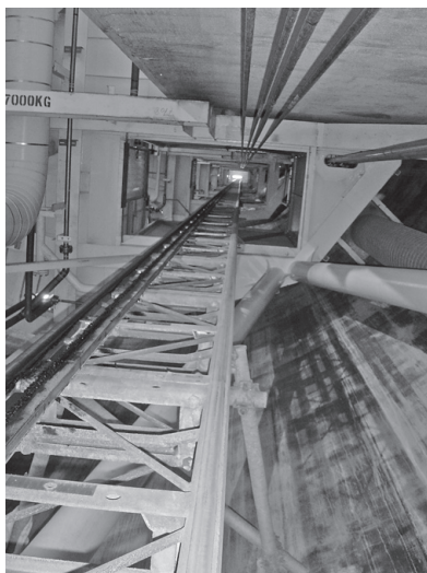
Alimak med løftehøyde 150 m
