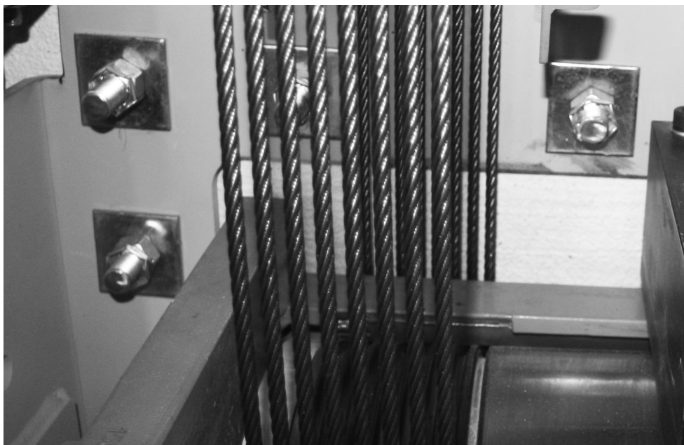
Maskinramme festet med bolter i vegg. Sannsynligvis limbolter.
