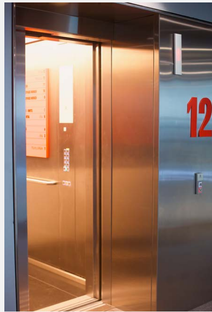
Det er 8 Schindler 5500 i museet.
