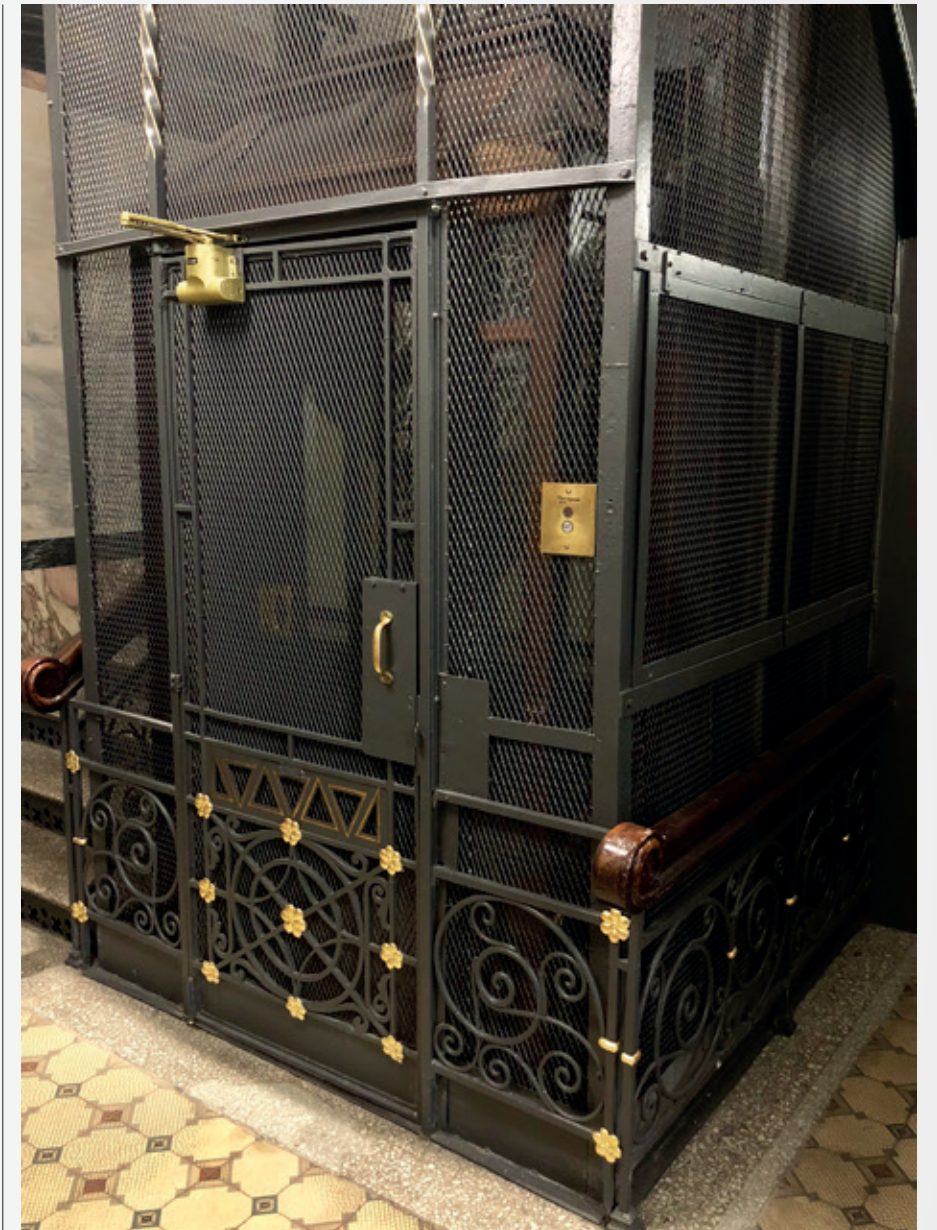
Det som trolig er Norges eldste heis som ble montert i 1898 før vi fikk «Osloforskriften». Foto: Lundberg
