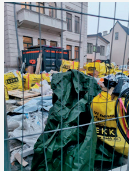
Fra byggeplassen i Wergelandsveien ble man møtt av rot allerede på utsiden.
