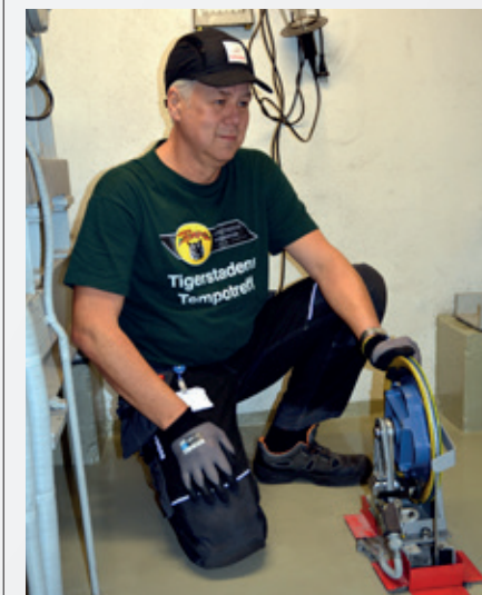
Her foretas en visuell kontroll av hastighetsbegrenseren. Bl.a. kan en slitt o-ring påvirke utløserhastigheten.
