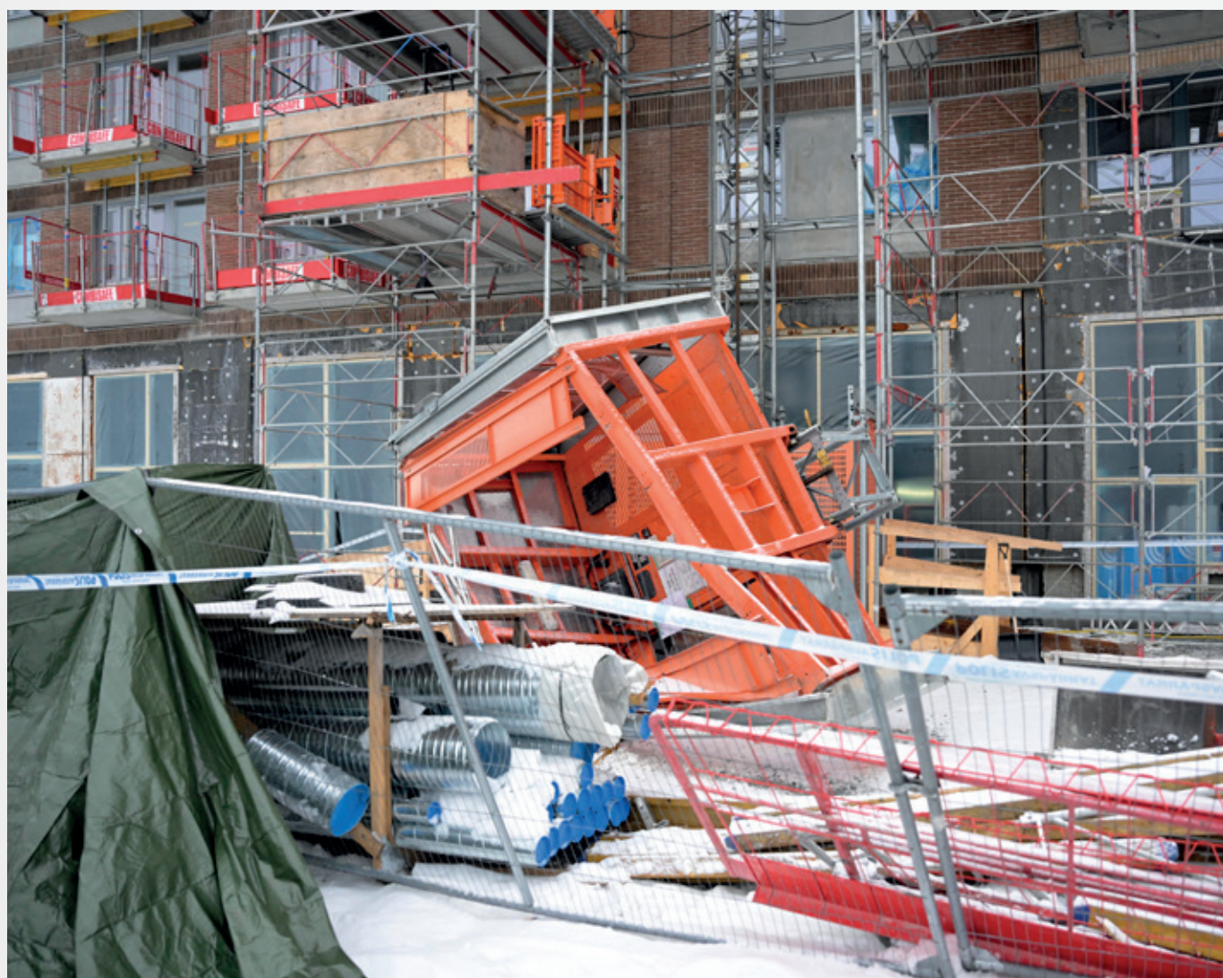
Fem personer omkom når en byggeheis på en byggeplass utenfor Stockholm raste 20 meter. Statens havarikommisjon og politiet utreder ulykken. Foto: Fredrik Sandberg/TT/NTB.
