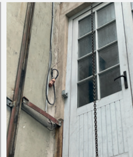
Innretningen kunne betjenes med et kjøretablå som hang på veggen i 2 etasje.
