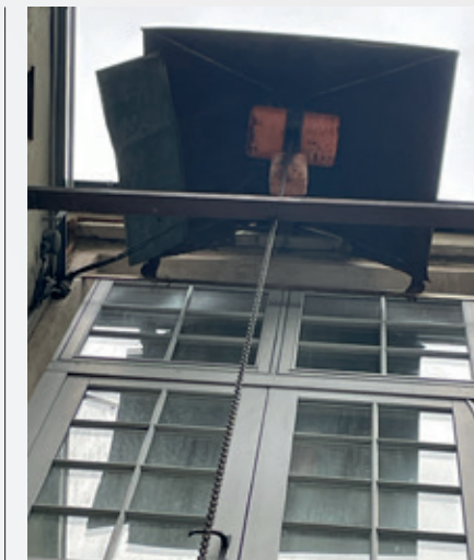
Det var ikke mulig å se om taljen hadde vært inne til årlig kontroll.
